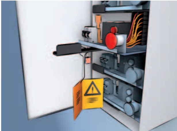
Le cadenas condamne la tringlerie de commande du tiroir.
